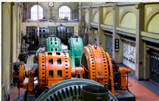
Hala generatorów prądu stałego w Międzynarodowym Laboratorium Silnych Pól Magnetycznych i Niskich Temperatur PAN we Wrocławiu.
